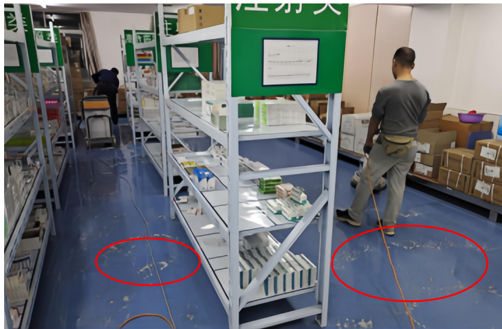
翻新前：破损划痕严重
